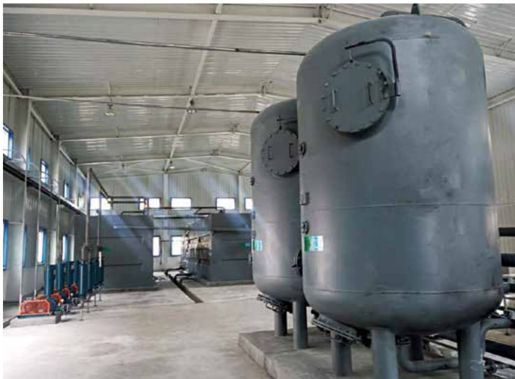
西藏華泰龍新建污水處理廠處理設備
