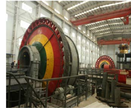
❖ 主要设备已安装
