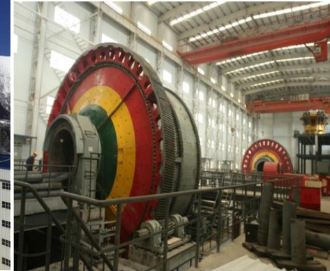
❖ 主要设备已安装
